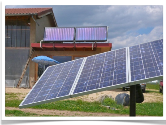
Production électricité en premier plan et chaleur en toiture, juillet 2012
